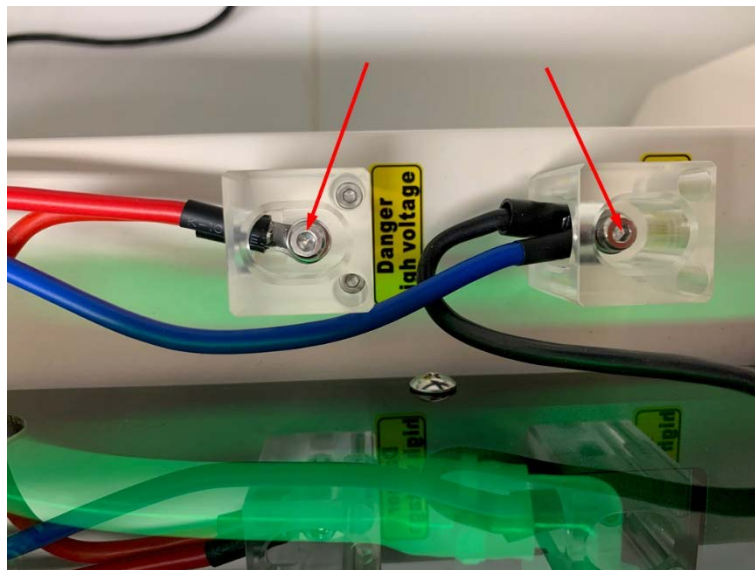
Imagen 27 Cables de conexión de la lámpara láser
