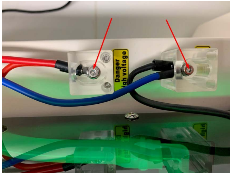
Figure 27 Câbles de raccordement de la lampe laser
